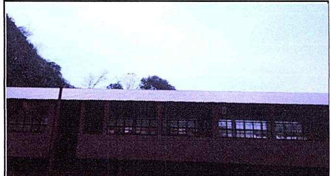
Foto 4: lamina de la escuela en mal estado
