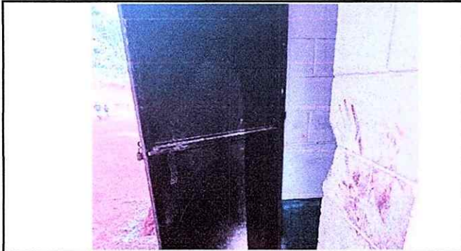
Foto 3: puerta del baño en mal estado
