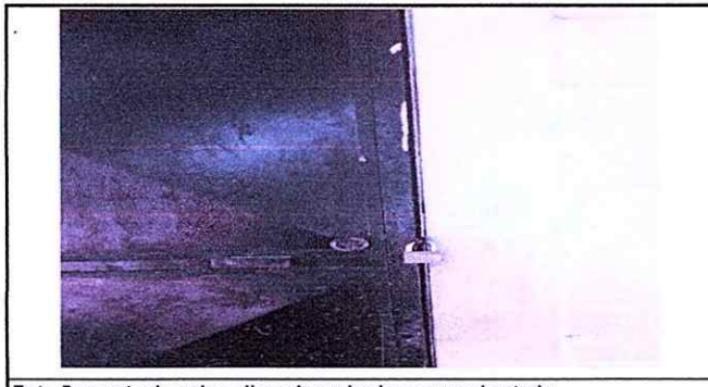
Foto 5: puerta de aulas, direccion y bodega en mal estado
